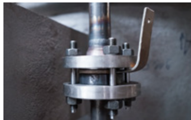
可调节孔板, 用于规范所需注入的蒸汽量
